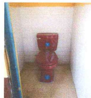
Foto 4: Se observa que se cambiaron inodoros en los servicios sanitarios.
