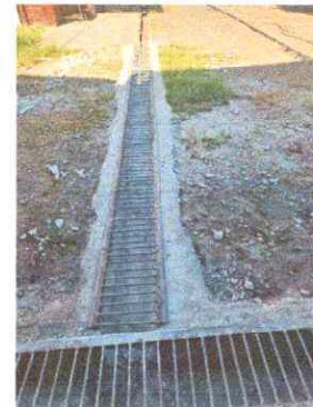
Foto 10: Se observa que se aseguró y se le dio mantenimiento a cuneta de concreto.
