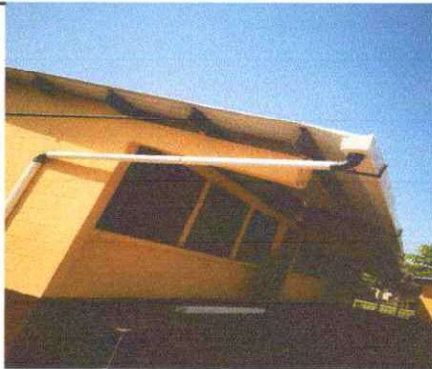
Foto 9: Se observa que se hizo la sustitución del canal pluvial.
