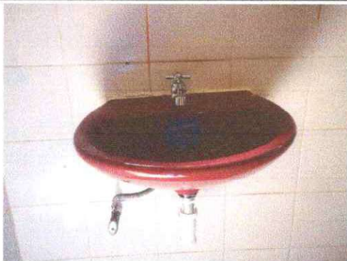
Foto 1: Se observa que en módulo de servicios sanitarios se sustituyó lavamanos por deterioro.
