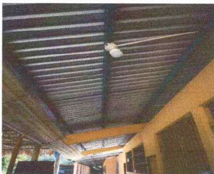
Foto 11: Se observa que se le dio el mantenimiento a la red eléctrica de las instalaciones del plantel educativo.
