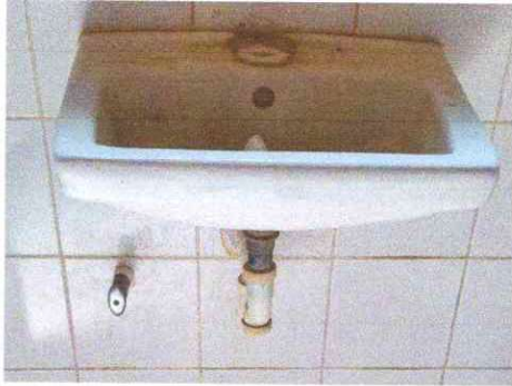
Foto 1: Se observa que en modulo de servicios sanitarios es necesario sustituir lavamanos por deterioro.
