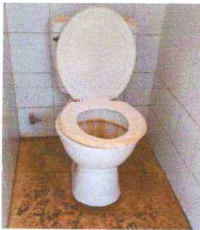
Foto 3: Se observa fugas en inodoros el cual es necesario darle mantenimiento.
