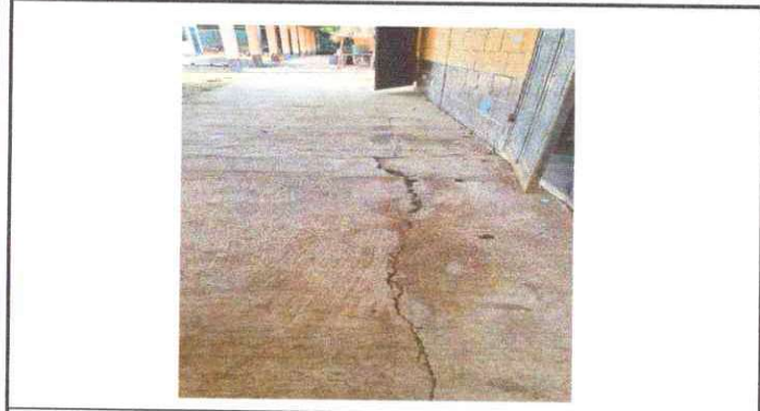
Foto 13: Se observa que es necesario reparar torta de concreto en respectivos pasillos.
