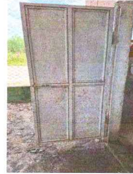
Foto 2: Se observa que es necesario la sustitucion de puerta en el modulo de servicios sanitarios.
