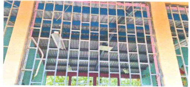
Foto 8: Se observa que necesario el mantenimiento de balcones en módulo III.
