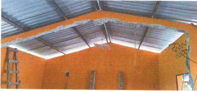
Foto 7: Se observa que es necesario soporte de metal para módulo I.
