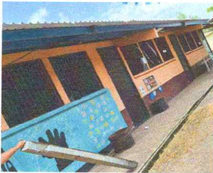
Foto 9: Se observa que es necesario sustituir canal pluvial por deterioro.
