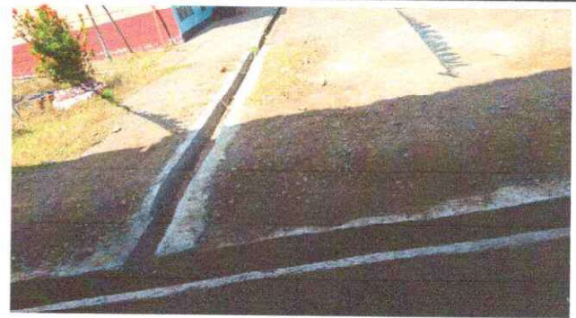
Foto 10: Se observa que es necesario asegurar y darle mantenimiento a cuneta de concreto.
