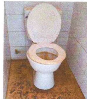
Foto 4: Se observa que es necesario el cambio de inodoros en servicios sanitarios.
