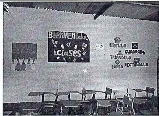
Foto 4: Se observa que aula carece de ventilación e iluminación cruzada
