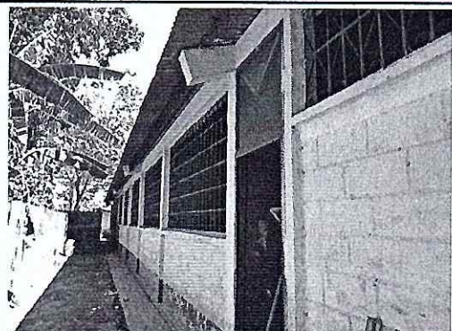
Foto 2: Se observa que muros exteriores e interiores necesitan resane y aplicación de pintura
