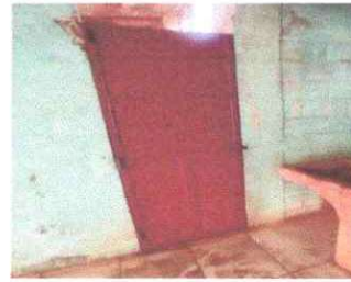
Foto 2: Se observa puerta sustituida.
