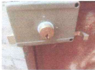
Foto 3: Se observa sustitución de chapa.
