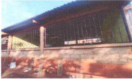
Foto 7: Se observa la sustitución de ventanales por balcones
