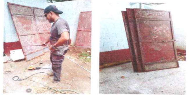
FOTO 8: Mantenimiento de puertas de metal (incluye lijado, cepillado, cambio de tubo y aplicación de pintura anticorrosiva + esmalte)
