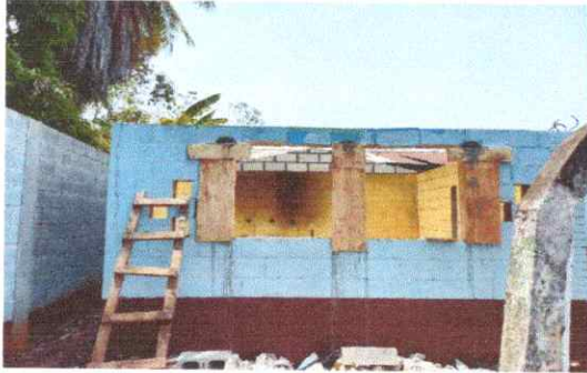
FOTO 13: Sustrucción de lámina por lámina troquelada calibre 26 (incluye tornillos, montaje y desmontaje)
