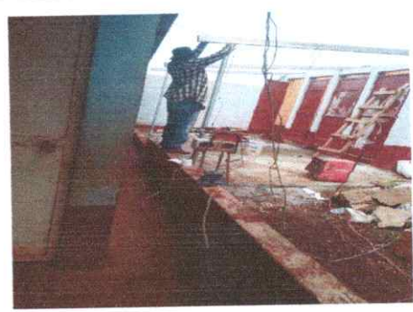
FOTO 2: Sustitución de estructura de soporte de metal (incluye columnas metálicas y base de concret)
