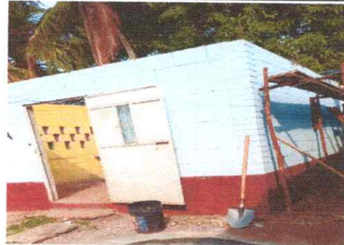
FOTO 22: Mantenimiento de puerta de metal (incluye lijado, cepillado, cambio de tubo y aplicación de pintura anticorrosiva+ esmalte)
