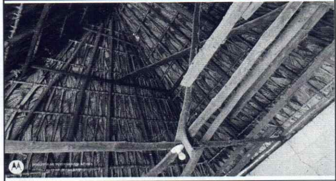
Foto 14: Sustitución de estructura de soporte de metal (incluye conformación de muro + mojinete)
