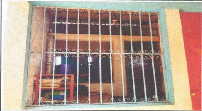
Foto13: Se observa necesidad de mantenimiento a balcón de metal
