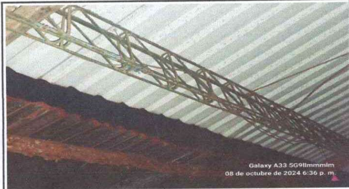
Foto 2: Se observa la estructura metalica del techo en mal estado
