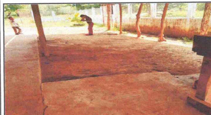
Foto 3: Se observa Torta de concreto incompleta y en mal estado
