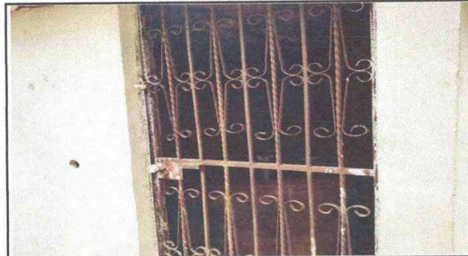
Foto 4: Se observa puerta en deterioro en area de pozo
