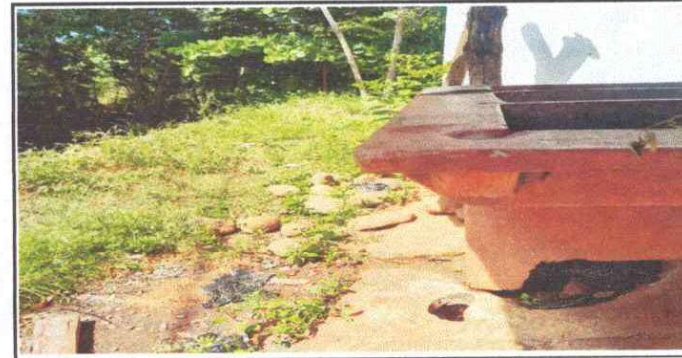
Foto 6: Se observa necesidad de suministro de grifo
