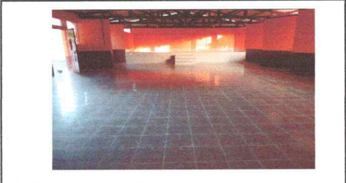
Foto 7: Se observa terminada e instalado el piso cerámico en el salón de usos múltiples
