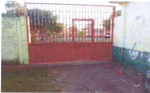
Foto 5: Se observa el cambio de portón de metal en mal estado
