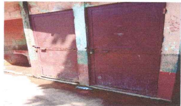
Foto 4: Se observa la necesidad de hacer el cambio de puertas en mal estado
