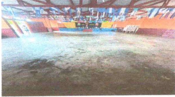
Foto 1: Se observa que el piso necesita mejora
