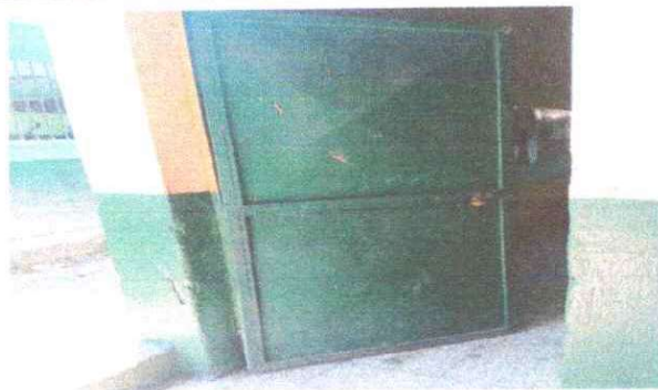
Foto 3: Se observa que la puerta se encuentra en mal estado
