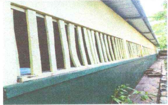
Foto 2: Se observa los balcones en mal estado
