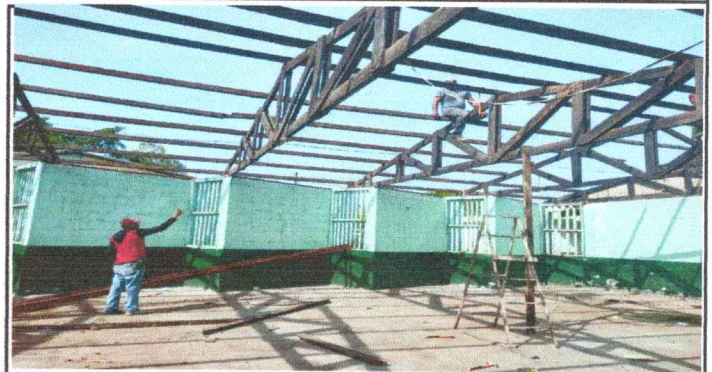
FOTO 2: se observa el proceso de cambio de estructura de madera que estaba en mal estado.
