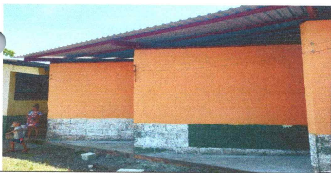
FOTO 3: Se observa el proceso de pintado que estaba en mal estado.
