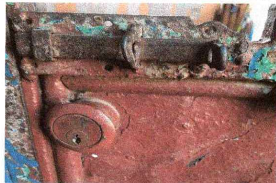
Foto 4: Se observa el cambio de chapa a puerta
