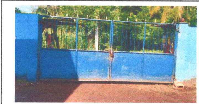
Foto 13: Se observa en mal estado el portón y sin seguridad
