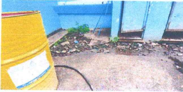
Foto 7: Se observa en mal estado la torta de cemento de acceso a los sanitarios
