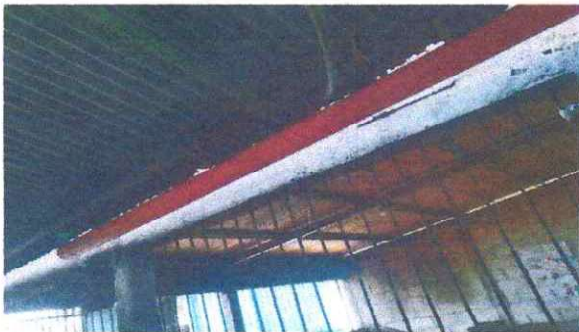
Foto 5: En mal estado bajada agua
