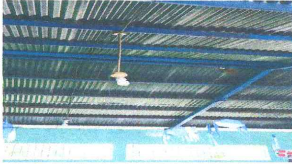
Foto 1: Se observa que la lámina de zinc, se encuentra en mal estado con varios agujeros
