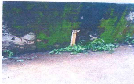
Foto 10: Se observa en mal estado de línea principal
