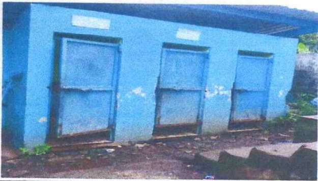
Foto 9: Se observa en mal estado puertas de Servicio Sanitario
