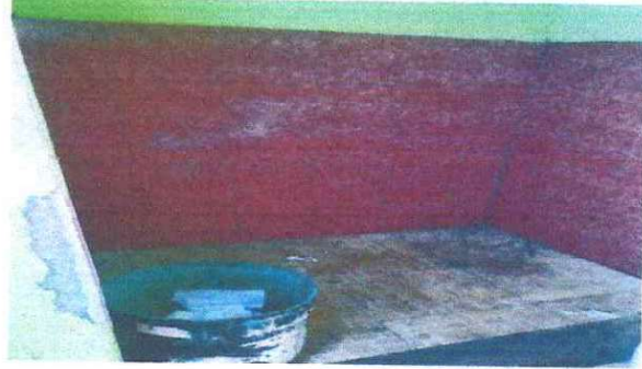
Foto 8: En mal estado Mingitorio
