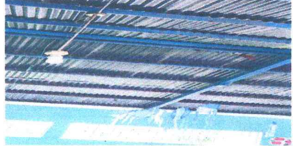
Foto 2: Falta de mantenimiento y deteriorado parte de la estructura
