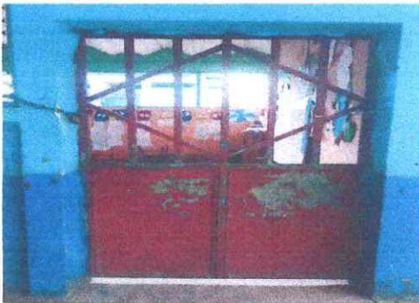
Foto 3: Se observa en el mal estado la puerta del aula
