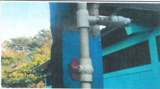
Foto 3: Se observa que es necesario sustituir llave de cheque de red de agua potable
