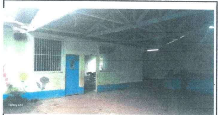
Foto 2: Se observa la estructura de soporte de madera que es necesario sustituirla por metal.
