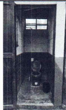
FOTO 8: SE OBSERVA EL PISO RÚSTICO, URGE PISO ANTIDESLIZANTE Y LA PAREDES SUCIAS Y SIN AZULEJO.
