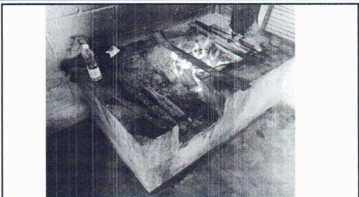
FOTO 2: SE OBSERVA EL MAL ESTADO DE LA ESTUFA RURAL Y QUE NO CUENTA CON LA PLANCHA DE METAL COMPLETA.
