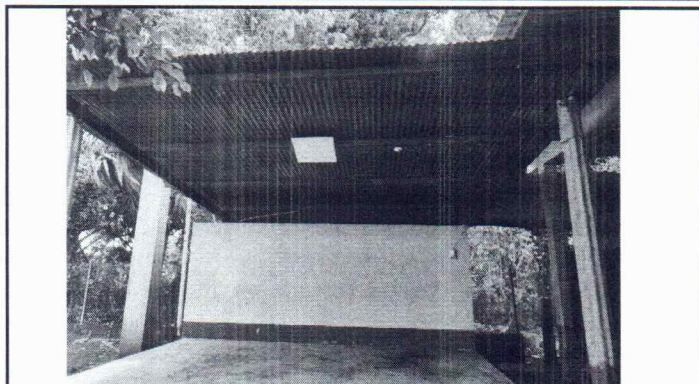
FOTO 1: SE OBSERVA EN EL ESCENARIO EL DETERIORO DE LÁMINAS Y EL ÓXIDO DE LA ESTRUCTURA DE SOPORTE, URGE SUSTITUCIÓN.
