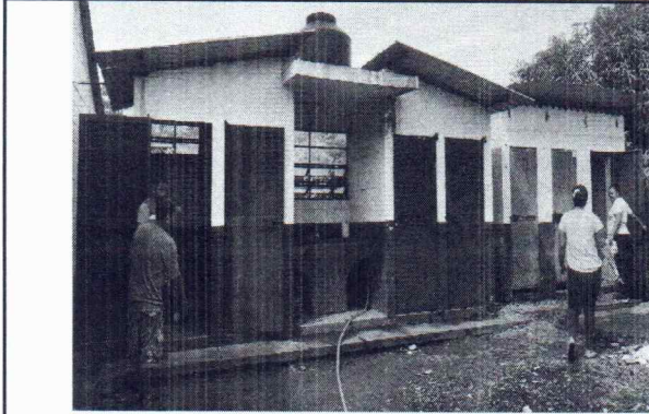
FOTO 7: SE OBSERVA LA PAREDES SUCIAS Y SIN PINTURA.
