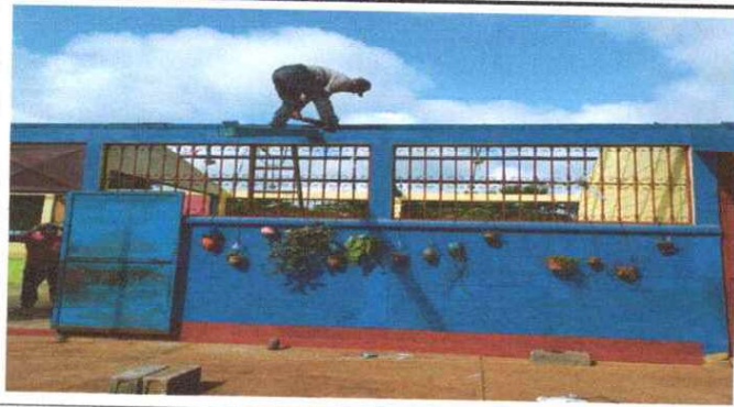
FOTO 1: Se observa que la lamina fue removida.
