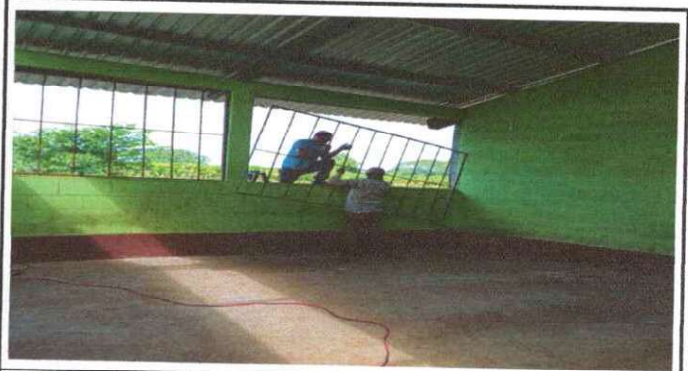
Foto 4: Se observa que los balcones fueron retirados.
