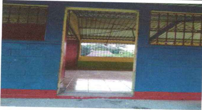
Foto 3: Se observa que la puerta fue retirada.
