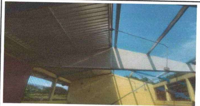
Foto 2: Se observa que la estructura fue quitada y colocada.
