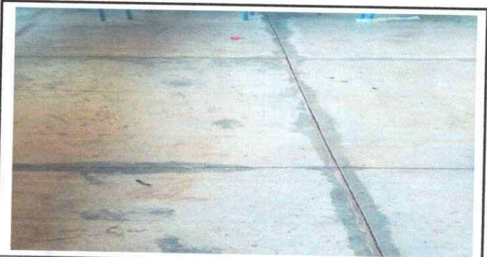
Foto 6: Se observa la necesidad de sustituir piso de cemento por piso ceramico.
