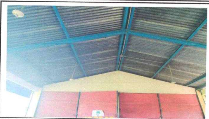
Foto 2: Se observa que la estructura esta en mal estado se necesita sustitucion de estructura de soporte.
