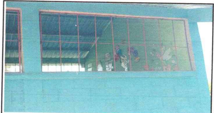
Foto 4: Se observa que los balcones se encuentran en mal estado se necesita sustitución.
