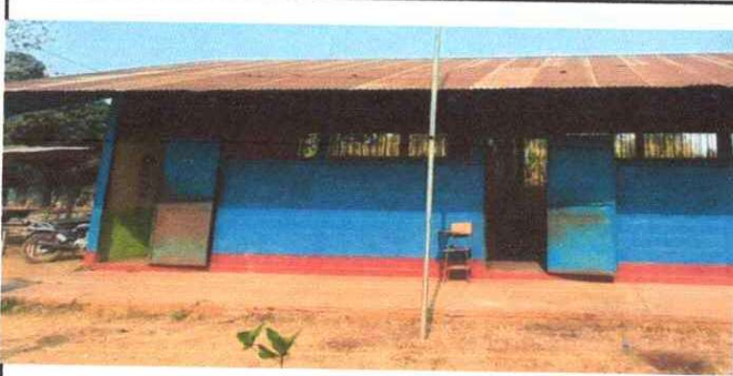
Foto 1: Se observa que la lámina de zinc, se encuentra en mal estado
