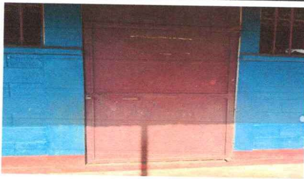
Foto 3: Se observa que la puerta se encuentra en mal estado se necesita sustitucion.
