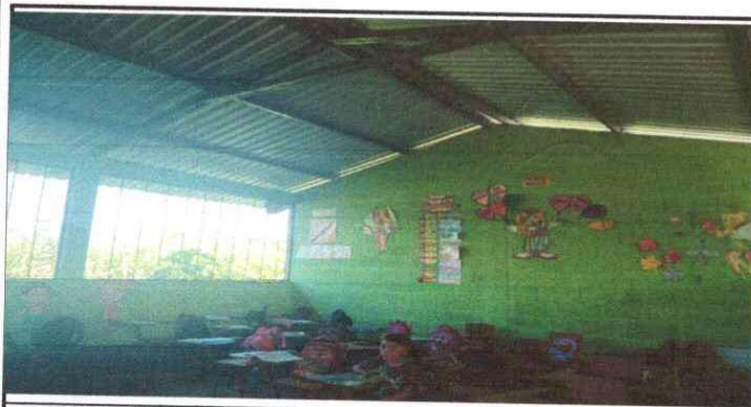
Foto 5: Se observa la necesidad del sistema electrico.
