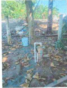
Foto 13: Se observa la instalación completa de la bomba de agua.
