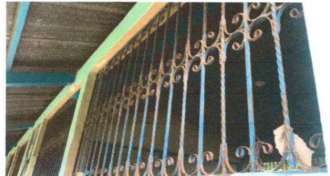
Foto 4: Se observa que en las aulas las ventanas de metal necesitan mantenimiento.
