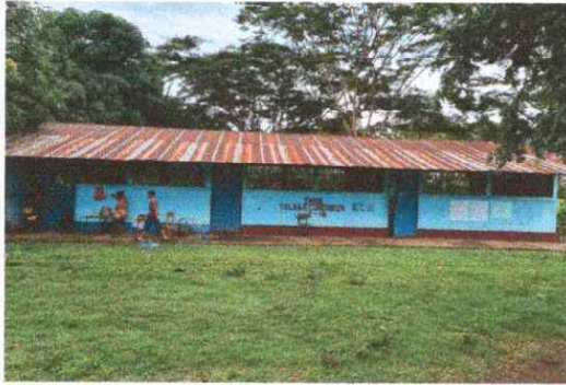
Foto 1: Parte frontal del edificio, se observa que las láminas existentes se encuentran con mucho óxido en la parte de arriba.
