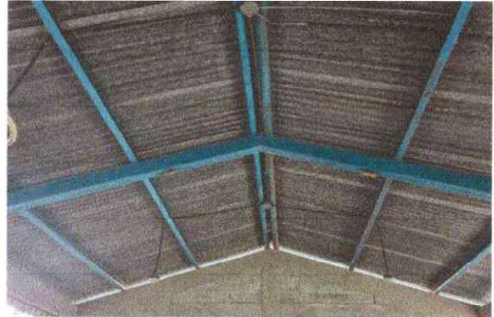
Foto 2: Se observa que la estructura de soporte de metal es necesario su mantenimiento.
