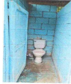
Foto 14: Se observa que las paredes necesitan repello.
