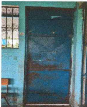
Foto 3: Se observa la puerta de aula con mucho óxido y necesita urgentemente mantenimiento.
