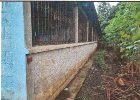
Foto 5: Se observa que en aulas es necesario aplicación de pintura.
