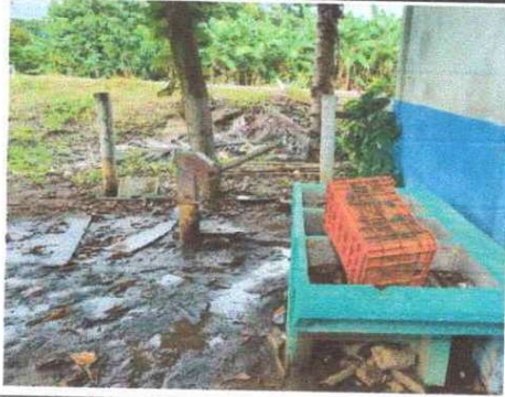
Foto 13: Se observa el lugar donde se instalará la bomba de agua para abastecer del vital líquido al rotoplast y ser uso de los servicios sanitarios y la pila.
