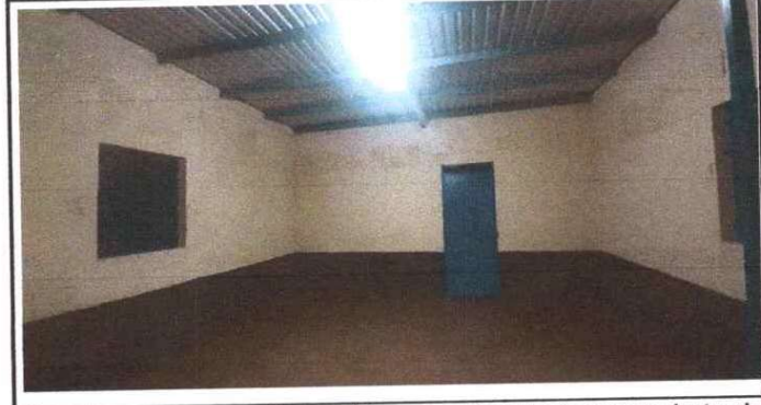
Foto 4: La pintura ya perdio su brillo a causa de la lluvia que cae dentro de las aulas
