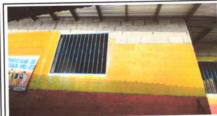
Foto 3: el muro de las aulas no tiene la altura adecuada esta muy bajo y hace mucho calor cuando los niños reciben clases
