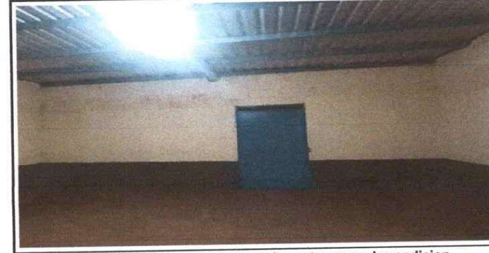
Foto 6: Las puertas de madera de las aulas estan en malas codicion
