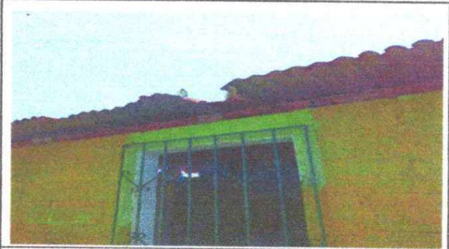
Foto 2: La estructura de techo de madera esta en malas condiciones por el agua de lluvia
