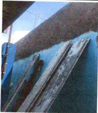
Foto 3: CERNIDO DE MURO: Se observa que hace falta cernido
