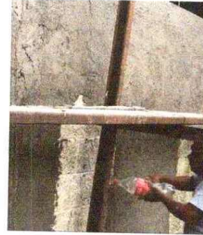
Foto 2: REPELLO DE MURO: Se observa que hace falta repello
