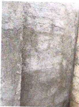
Foto 3: CERNIDO DE MURO: Se observa que hace falta cernido
