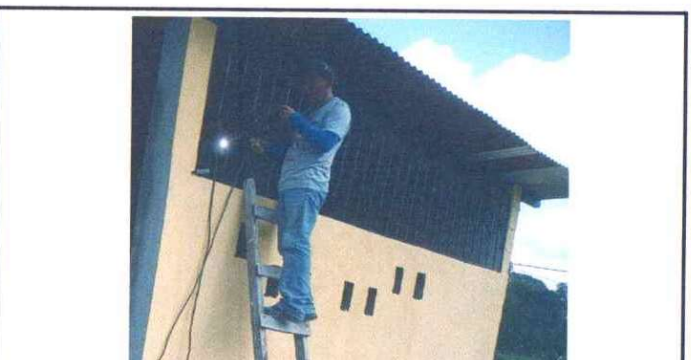
Foto 12: Sustitución de balcon no cuenta con seguridad en cocina.
