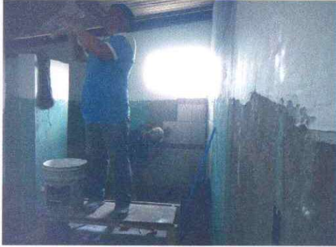
Foto 13: Sustitución de sistema eléctrico: el sistema esta deteriorado
