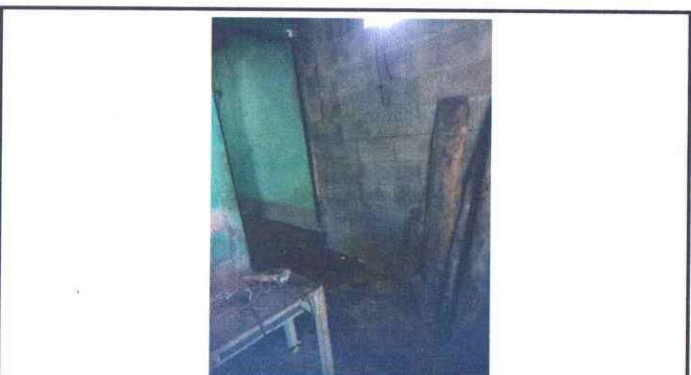
Foto 10: Sustitución de puerta de servicio sanitario: las puertas están deterioradas.
