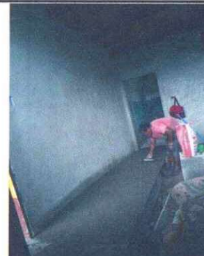
Foto 4: Sustitución piso torta de concreto: se necesita alcanzar una altura aducada y esta en malas condiciones.
