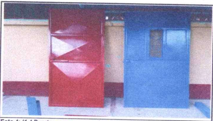
Foto 4: (1.4. Puertas con su respectivo mantenimiento.)
