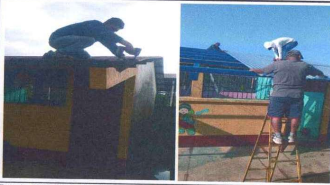
Foto 1: Módulo 1. (1.1.Sustitución de lamina en mal estado)
