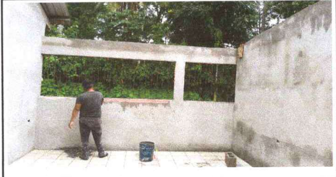
Foto 4: Repello de muro: Se observa que no tiene repello la pred y tiene mucha humedad.
