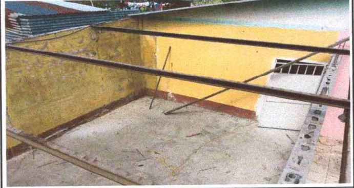
Foto 2: Sustitución de estructura de metal por metal: Se observa que las costaneras estan muy oxidadas y muy picadas.
