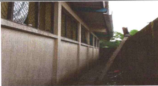
Foto 3: Sustitución de balcones de metal: Se observa que estan picados por oxido.
