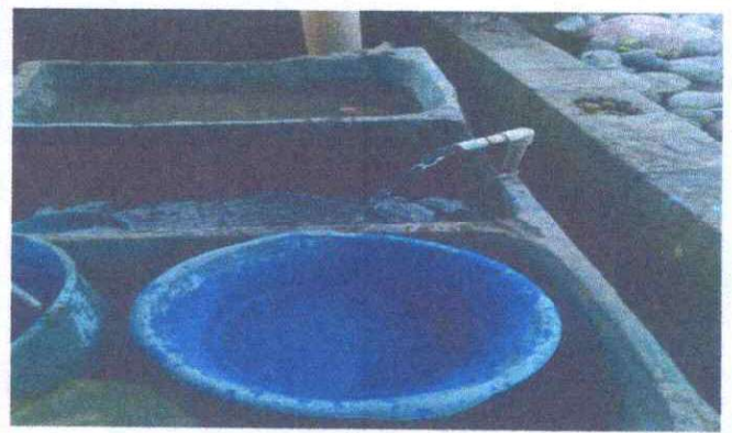
Foto 8: (1.9.Pila deteriorada no apta para alumnos.)
