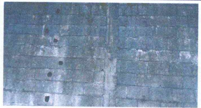
Foto 10: MÓDULO 4 (1.13.Muro deteriorado.)
