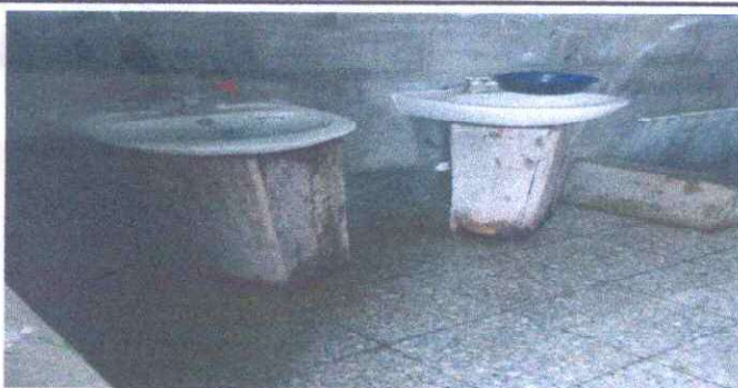
Foto 5: (1.6. Lavamanos en mal estado con fuga hidráulica.)
