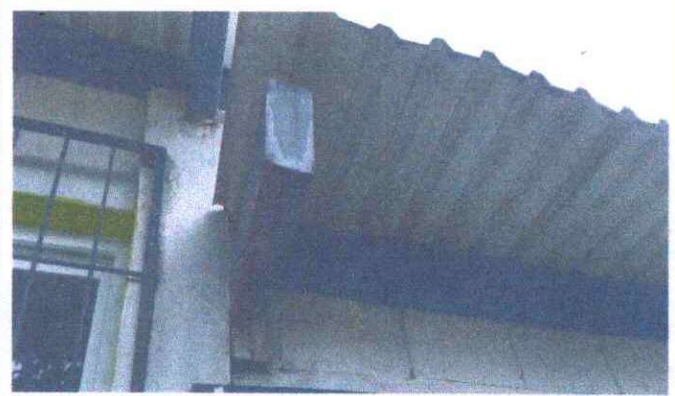
Foto 2: (1.2.Costaneras con pintura deteriorada.)
