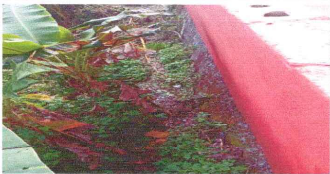
Foto 1: La pared esta al interperie se esta humedeciendo en el interior
