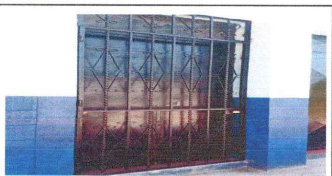
Foto 5: Las puertas estan deterioradas
