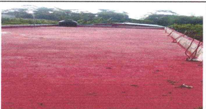
Foto 3: Trasmite humedad al interior
