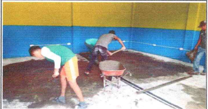
Foto 2: El piso se esta levantando del suelo natural
