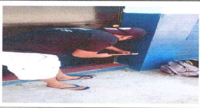
Foto 5: Las puertas estan deterioradas
