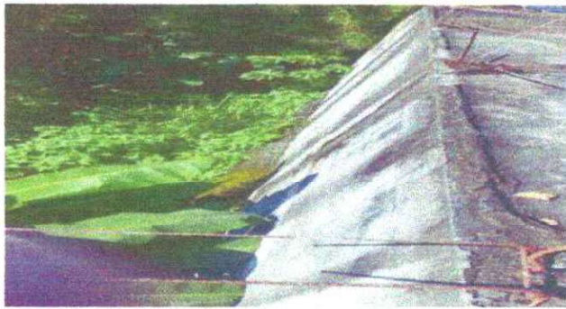
Foto 1: La pared esta al interperie se esta humedeciendo en el interior
