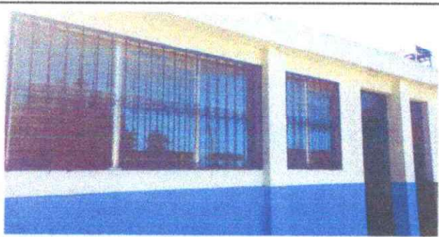
Foto 5: Las puertas estan deterioradas
