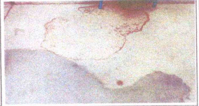
Foto 2: El piso de cemento ya está cariado
