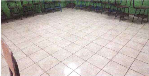
Foto 1: Suministro de piso cerámico el piso de concreto esta muy deteriorado.
