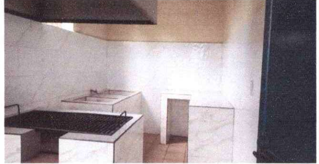
Foto 2: Suministro de azulejo las paredes no son higiénicas para la cocina.
