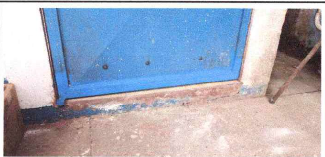
Foto 6: Mantenimiento de puerta se encuentra en malas condiciones.
