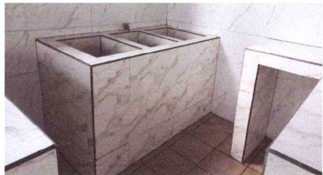
Foto 4: suministro de azulejo en pila , la pila acumula mucho cedimento no se puede hacer limpieza.
