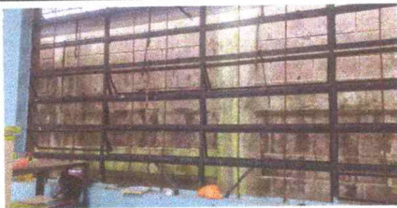
Foto 5: Mantenimiento de balconesse encuentra con corrosión
