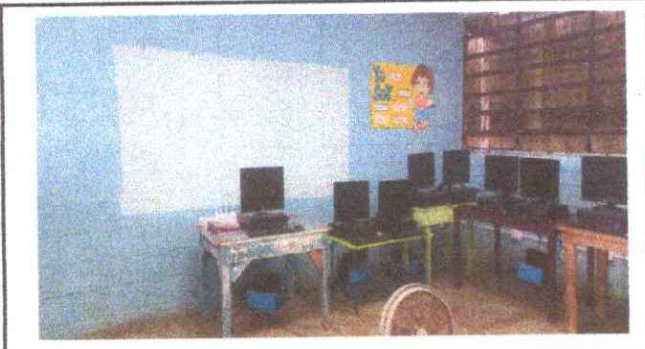
Foto 7: Resane y aplicación de pintura látex se encuentran sucias las paredes.
