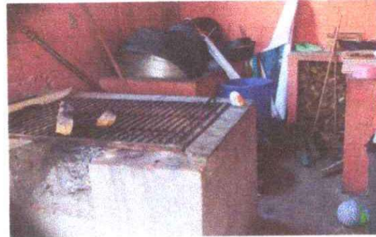
Foto 4: suministro de azulejo en pila , la pila acumula mucho cedimento no se puede hacer limpieza.
