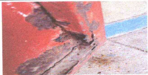
Foto 6: Mantenimneito de puerta se escntra en malas condiciones.
