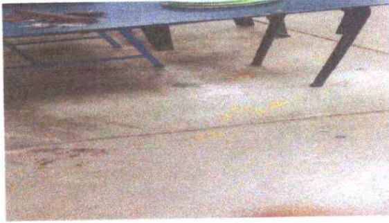
Foto 1: Suministro de piso cerámico el piso de concreto esta muy deteriorado. Se observa
