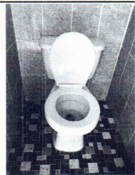
Foto 10: Se necesita reparar el inodoro, ya que no funciona correctamente ni retiene el agua.
