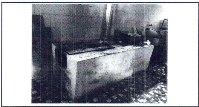
Foto 6: Se observa el mal estado de la estufa rural, presenta rajaduras en el área de la chimenea y las planchas están muy deterioradas.
