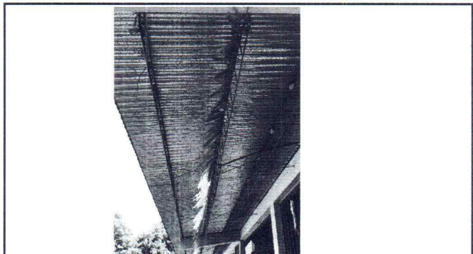
Foto 2: Se observa que la estructura de soporte se encuentra deteriorada, por lo que es necesario darle mantenimiento para prevenir su deterioro.
