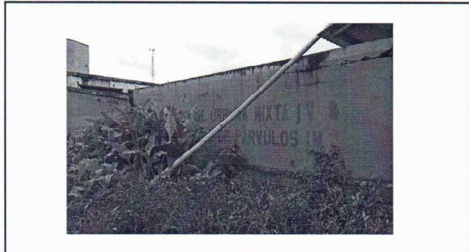
Foto 3: Se observa el muro perimetral de la parte de trasera que da a la carretera cito zarco que esta detenida con tierra y unos postes.
