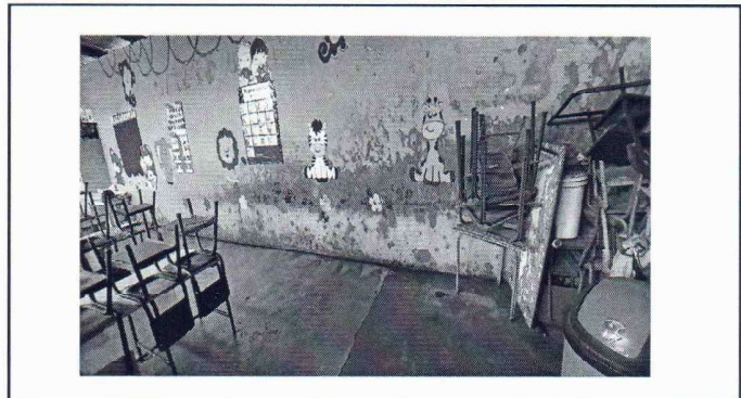
Foto 2: Se observa esta parte del muro perimetral es parte de un aula la cual esta muy dañada y corre riesgo de caerles a los niños.
