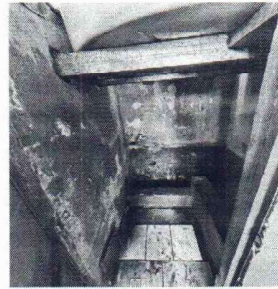
Foto 2: Se observa el mal estado de los sanitarios
