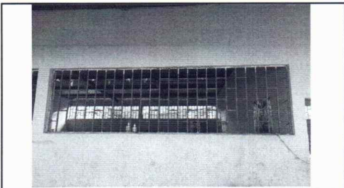
FOTO 4: SE OBSERVA EL ÓXIDO Y FALTA DE PINTURA EN BALCONES.
