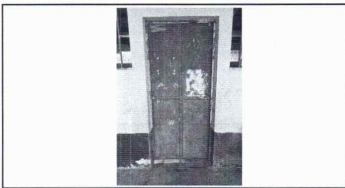
FOTO 5: SE OBSERVA EL ÓXIDO Y FALTA PEDAZOS AL MARCO DE LA PUERTA, URGE SUSTITUCIÓN.
