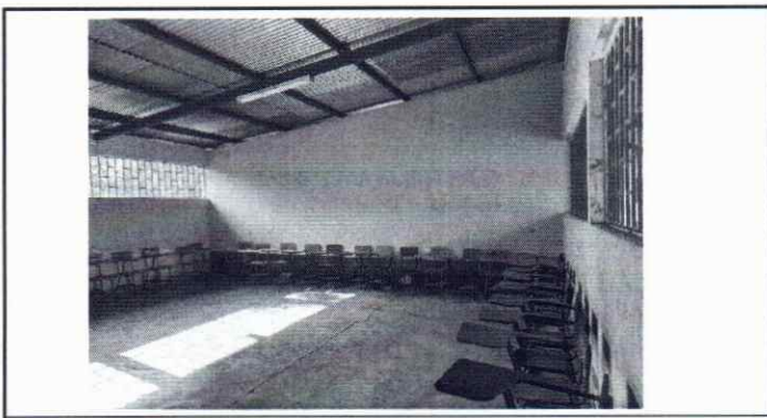
FOTO 6: SE OBSERVA EL DETERIORO DEL PISO.
