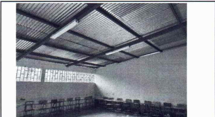
FOTO 2: SE OBSERVA EL SISTEMA ELÉCTRICO EN MAL ESTADO Y SE TIENE CORTO CIRCUITO EN MÓDULO 1, MÓDULO 2 Y MÓDULO 3.
