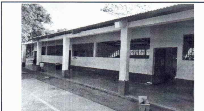
FOTO 3: SE OBSERVA LAS PAREDES SUCIAS Y SIN PINTURA.
