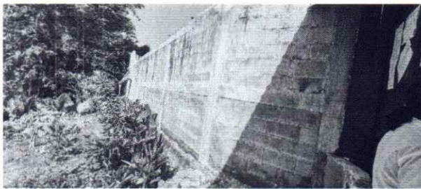
Foto 5: Se observa que el muro necesita ser repellido
