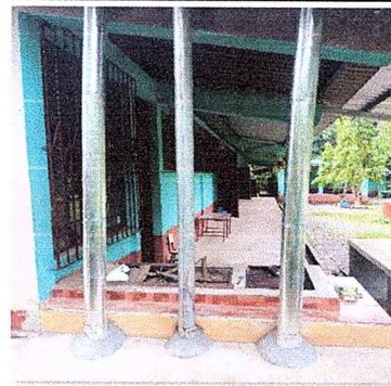
Foto 6: Se observa chimenea instalada.
