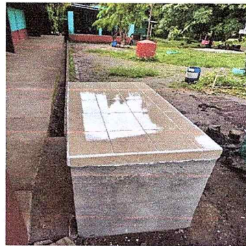
Foto 4: Se observa mueble de cocina instalado.
