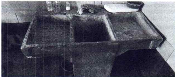
Foto 3: Se observa que se necesita la sustitución de la pila
