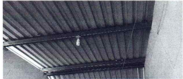
Foto 2: Se necesita la reparación del sistema eléctrico
