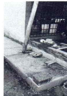
Foto 6: Se observa la necesidad de la sustitución de la chimenea
