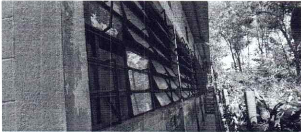
Foto 1: Se observa que se necesita la sustitución del balcón de metal
