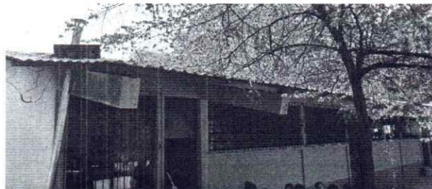
Foto 5: Se necesita la colocación de lamina y estructura de metal
