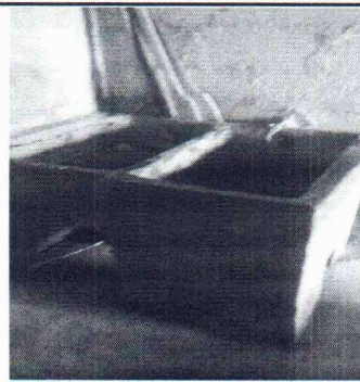
FOTO 2: Se observa que la pila de concreto esta en mal estado urge sustitución.
