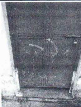
FOTO 10: Se observa que la pintura de las puerta de los baños se encuentra en mal estado, urge el cambio .
