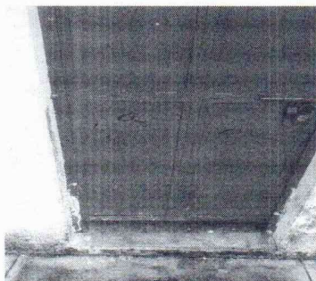
FOTO 9: Se observa que la pintura de la puerta de a acceso aulas se encuentra en mal estado urge el cambio .
