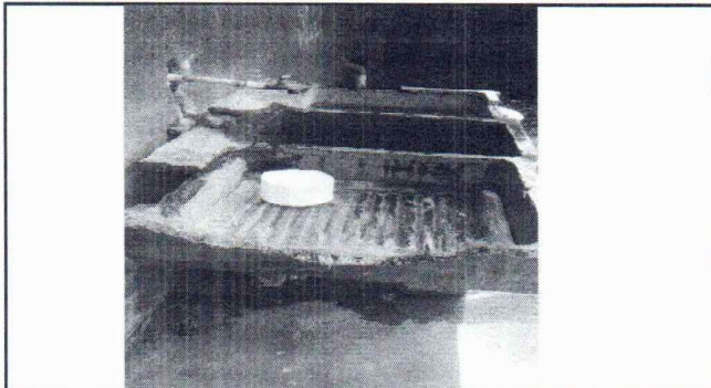
FOTO 15: Se observa que la pila esta en mal estado, por lo que urge la sustitucion del mismo.
