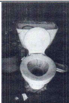
Foto 11: Se observa que los inodoros esta en mal estado por lo que se necesita sustitución del mismo.
