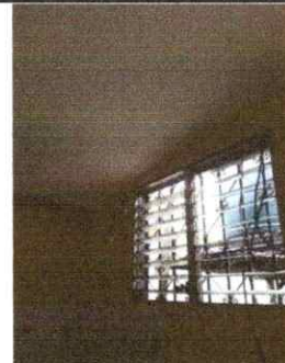
Foto 18: Trabajando el cambio de techo de lámina, estructura de madera, cielo falso
