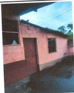
Foto 3: se observa la falta de canales para la bajada de agua
