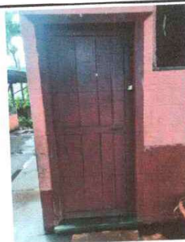
Foto 4: se observa el mal estado de las puertas.
