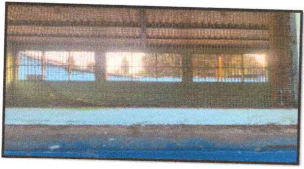
Foto 1: Se observa que las ventanas de los salones no cuentan con balcones por lo que es necesario colocar.
