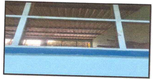
Foto 2: Se observa que los salones no cuentan con ventanas y se filtra el agua cuando llueve por lo que es necesario colocar.
