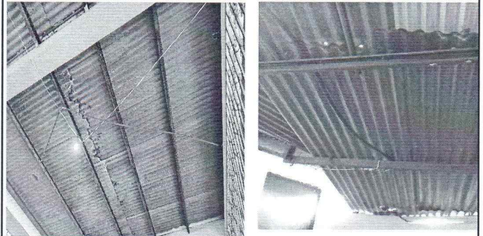
Foto 2: Se observa la estructura metálica deteriorada las vigas están oxidadas y perforadas.
