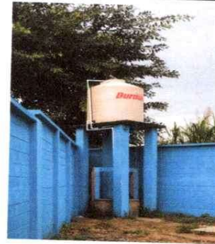
Foto 8: Se observa que se realizo sustitución del deposito de agua.
