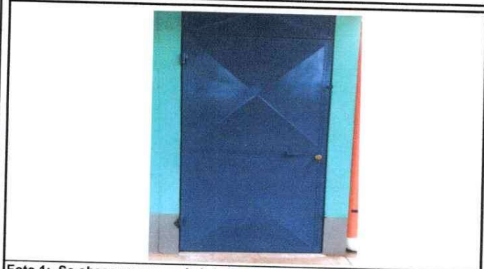
Foto 1: Se observa que se le brindo el mantenimiento requerido a la puerta.
