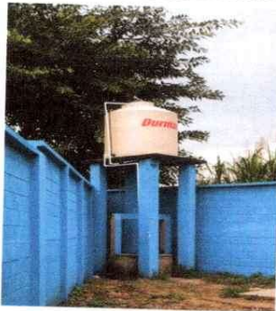
Foto 9: Se realizo la instalación de la bomba sumergible para abastecer de agua.
