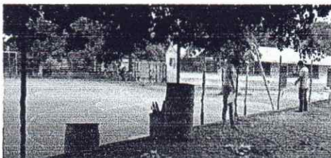
Foto 17: Se observa que la malla que ahí existia los amigos de lo ajeno se lo llevaron, y requiere de una sustitución de la misma.
