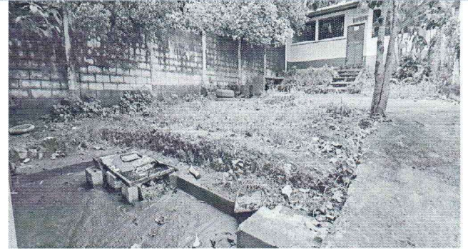
Foto 4: Se observa la necesidad de conformar un pequeño muro de protección para agua pluvial y su respectiva cuneta de concreto + rejilla. También se necesita suministrar pavimento de empedrado fraguado
