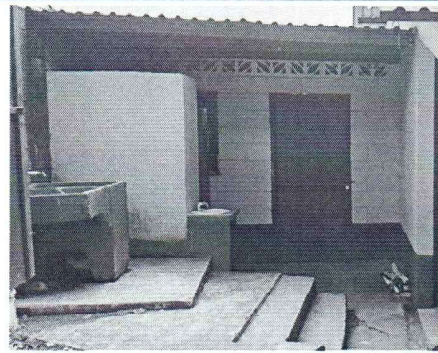
Foto 2: Se observa la necesidad de canales de agua pluvial en área de pila
