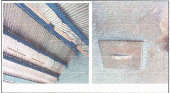
FOTO 2: Se observa que el sistema electrico se encuentra en mal estado.
