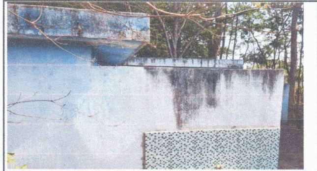
FOTO 3: Se observa que las paredes del establecimiento educativo se encuentra en mal estado por deterioro de la pintura
