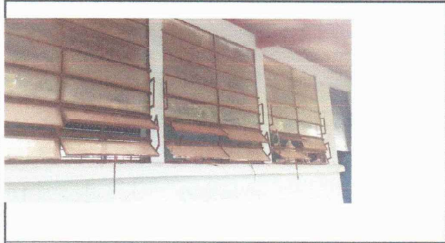
FOTO 1: Se observa la que los balcones necesitan ser sustituidos por balcon por metal es de carácter urgente.
