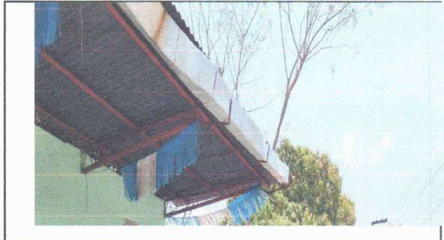
FOTO 4: Se observa que el canal de plastico esta en mal estado, necesitan sustitución por canal de metal .
